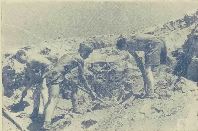
Na całej długości Trasy prowadzi się ogromne roboty ziemne. Ogółem wykonano 132.000 m 3 wykopów i nasypów.
