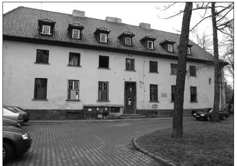
Budynek przy ul. Sienkiewicza 32 C wymaga gruntownego i kosztownego remontu
