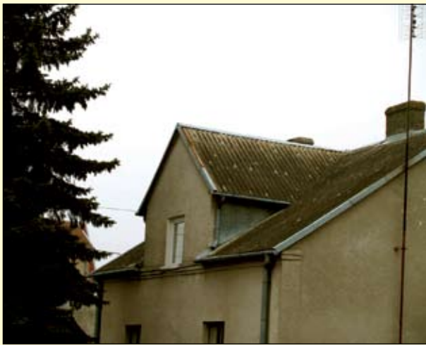
Skorodowane płyty cementowo-azbestowe są zagrożeniem dla zdrowia ludzi
